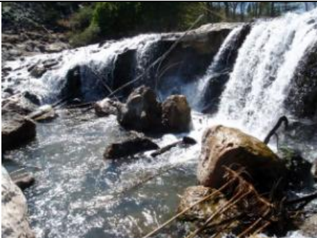
Enrochements fragilisés sur le centre du seuil de la prise d'eau du Canal du Vernet et Pia
