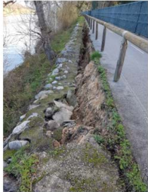
Photo 18 : Affaissement de la digue des Campings à Canet-en-Roussillon
