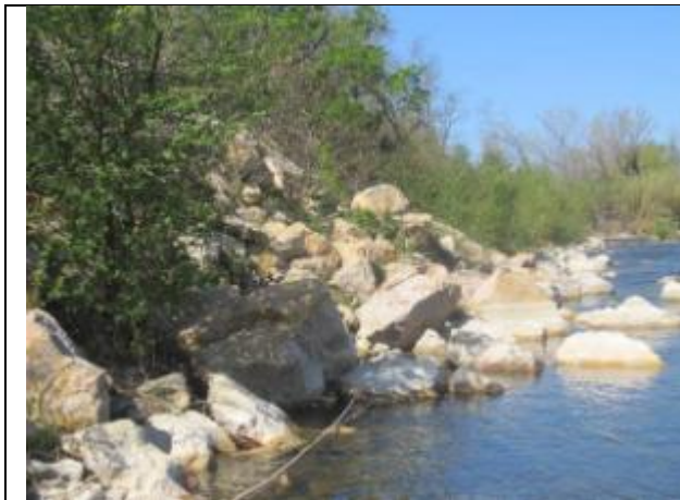
Talus de la RN 116 en au droit de St Feliu d'Avall
