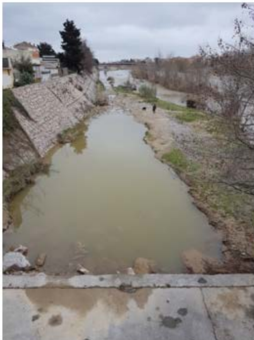
Photo 19 : Erosion de la berge basse de la digue Vernet-Est
